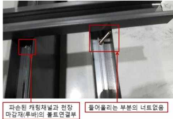
[떨어진 점검구의 상태]
